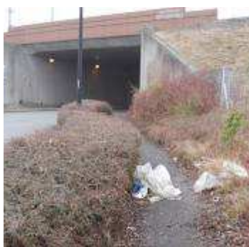
Trottoir encombré par des débris – CRT3
