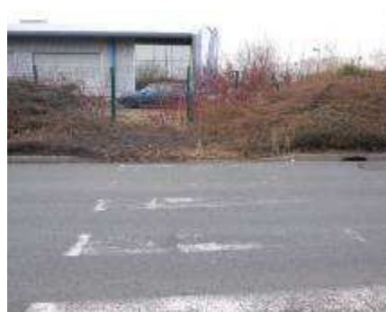
Accès au passage piéton impossible du fait de la végétation – CRT4
